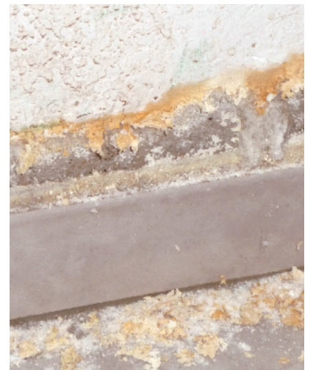
Schimmel an einer feuchten Zimmerwand.
