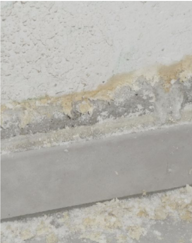
Schimmel an einer feuchten Zimmerwand
