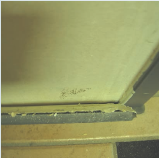
Abb. 1: Verschimmelte Tapete hinter dem Sockel.
