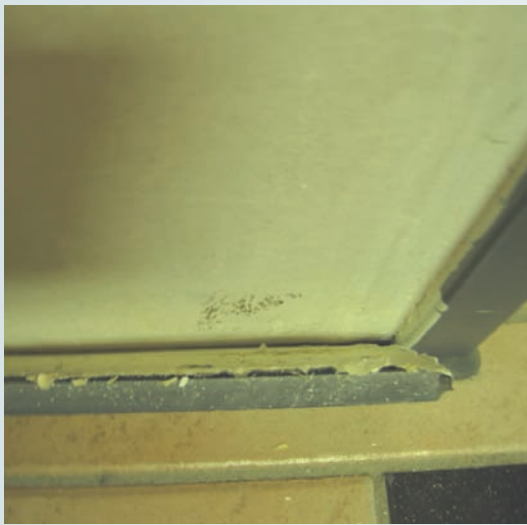
Abb. 1: Verschimmelte Tapete hinter dem Sockel.
