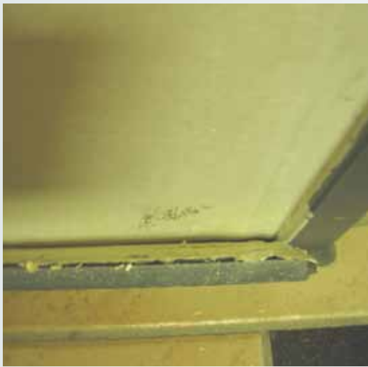
Abb. 1: Verschimmelte Tapete hinter dem Sockel.
