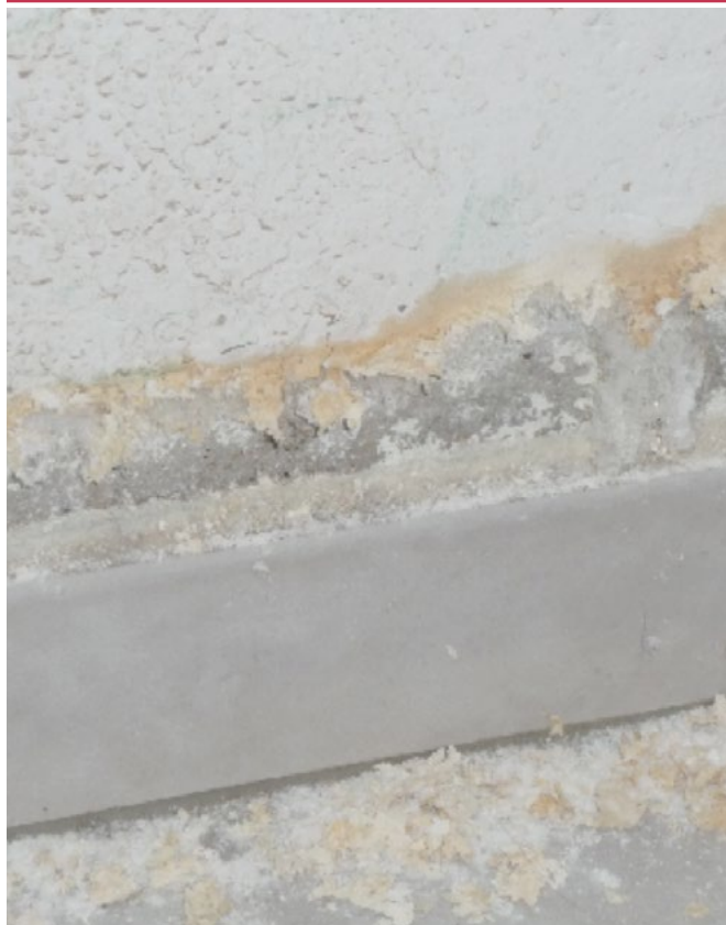
Abbildung 2. Sichtbarer Schimmelbefall im Haus
